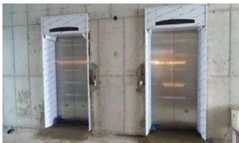
建築電梯設備
